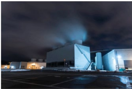
Tours de refroidissement du SPS et du LHC
